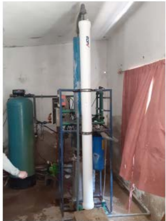
Figura 5.5-8 Equipo de Tratamiento "F" y Prefiltro "E" (Fuente: Propia)
