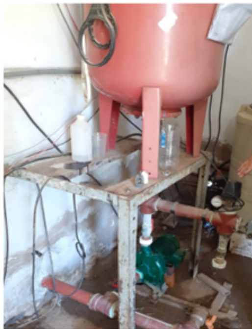
Figura 5.5-7 Bomba B3 y Tanque Hidroneumático (Fuente: Propia)
