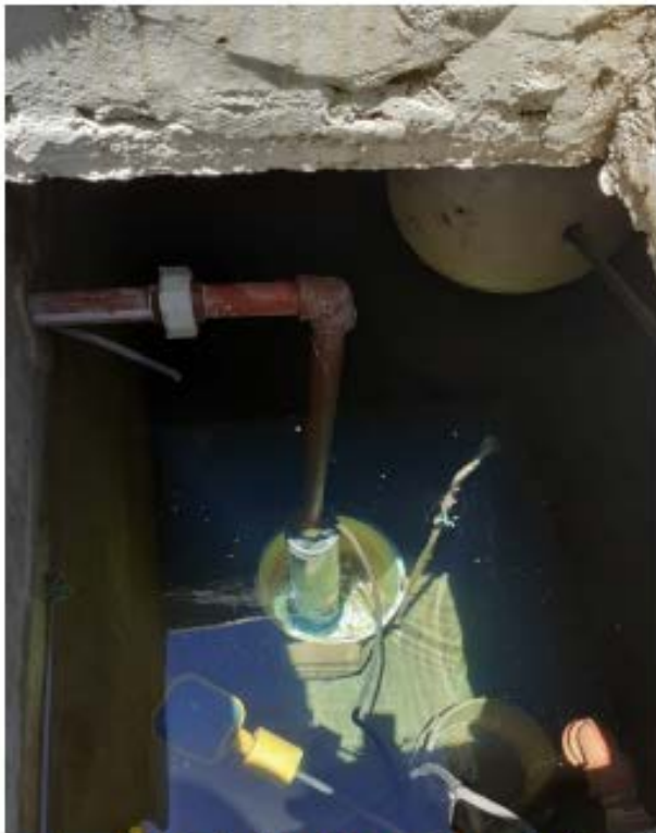
Figura 5.5-9 Bomba B2 en Cisterna A (Fuente: Propia)
