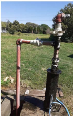
Figura 5.5-1 Salida de Bomba B1 (Fuente: Propia)
