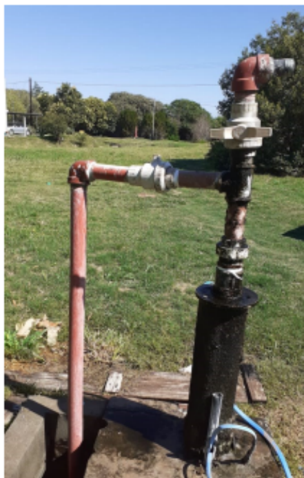
Figura 5.5-1 Salida de Bomba B1 (Fuente: Propia)
