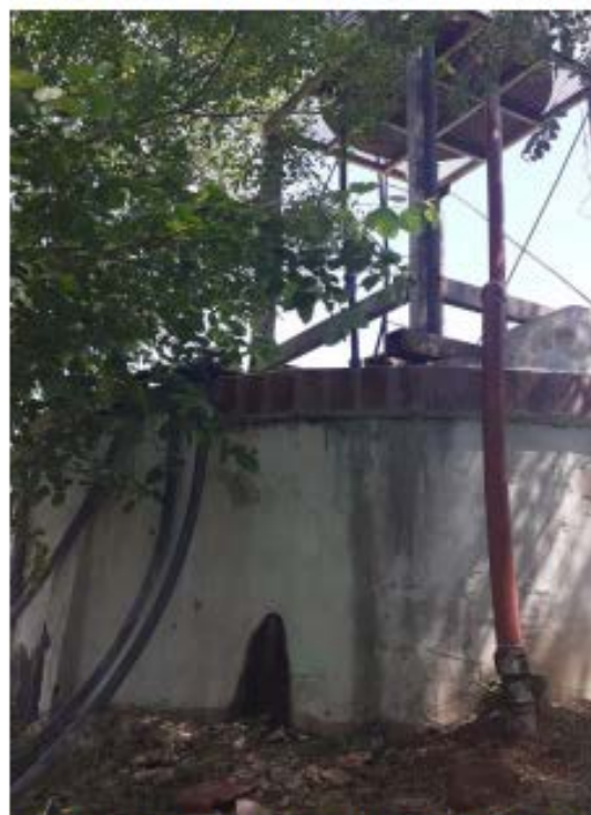
Figura 5.5-13 Vista bajadas de Tanque H (Fuente: Propia)
